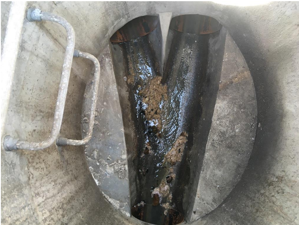
Foto no. 08 – Pozzetto n.113080
