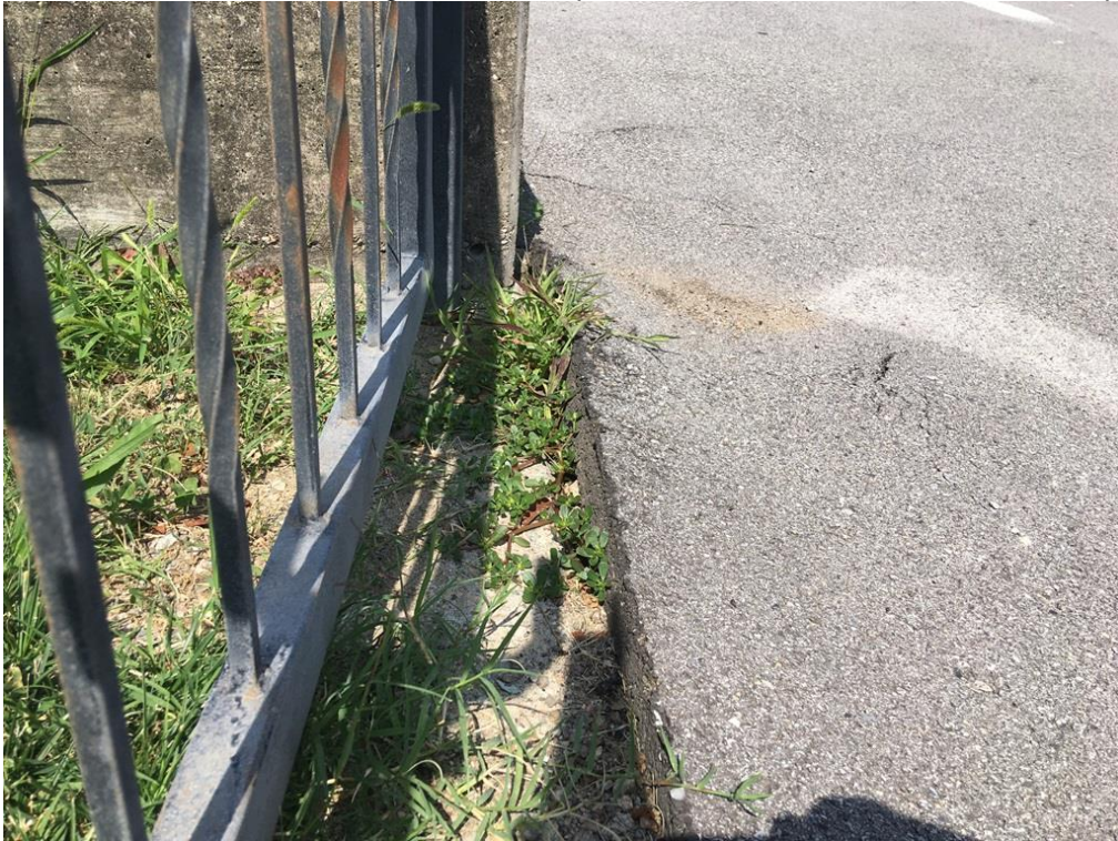
Foto no. 05 – Via ai Lungh, stato della pavimentazione stradale a confine con i privati
