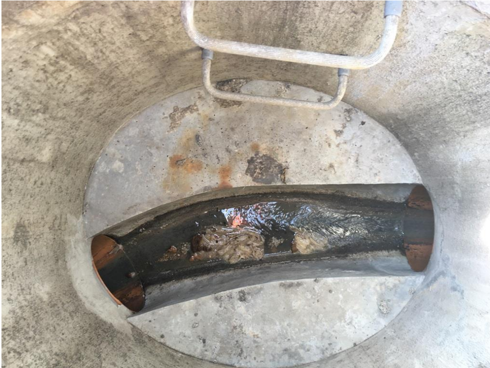
Foto no. 09 – Pozzetto n. 113090
