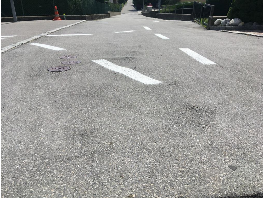
Foto no. 03 – Via ai Lungh, stato della pavimentazione stradale
