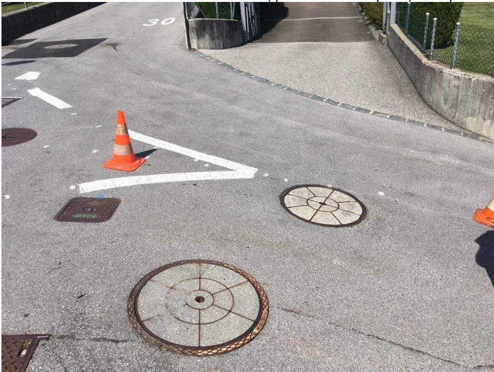
Foto no. 10 – Pozzetto n. 113230 (quello in secondo piano) non apribile
