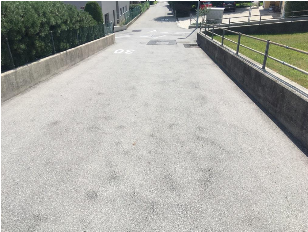
Foto no. 04 – Via ai Lungh, stato della pavimentazione stradale
