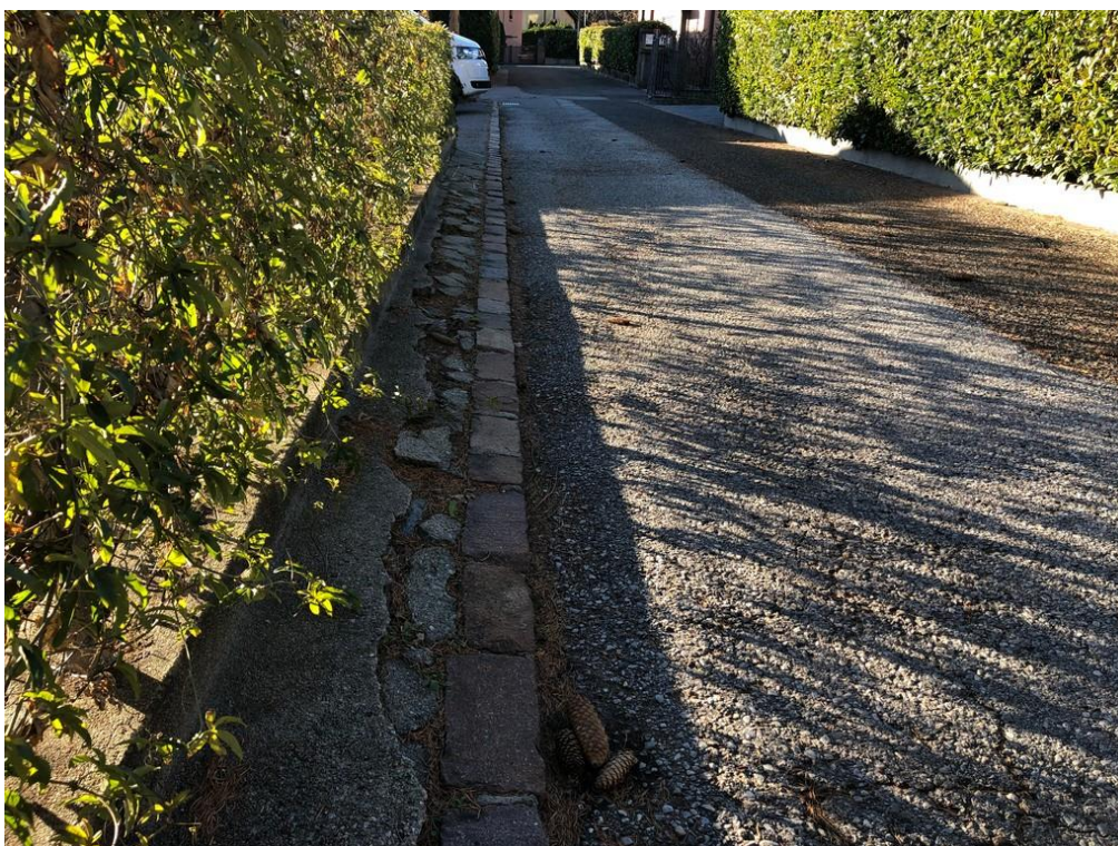
Foto no. 14 – Via Rovréd, stato della pavimentazione stradale a confine con il mappale 718
