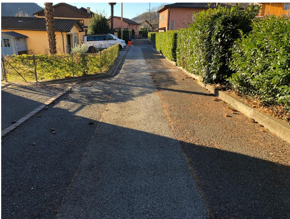
Foto no. 10 – Via Rovréd, stato della pavimentazione stradale
