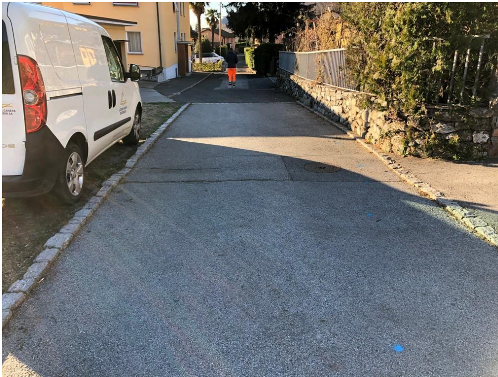
Foto no. 03 – Via Rovréd, stato della pavimentazione stradale
