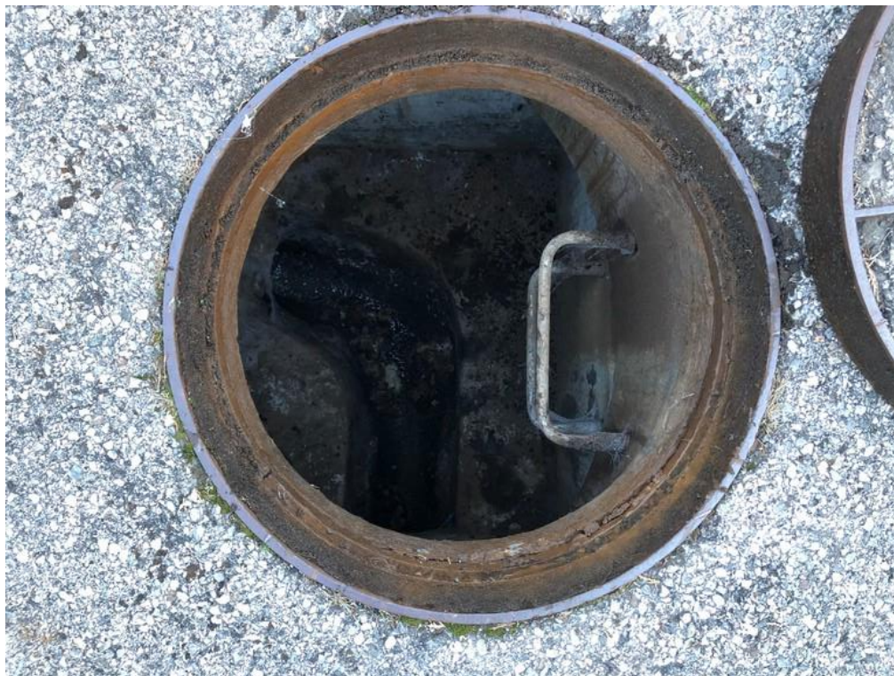
Foto no. 47 – Pozzetto n. 121590
