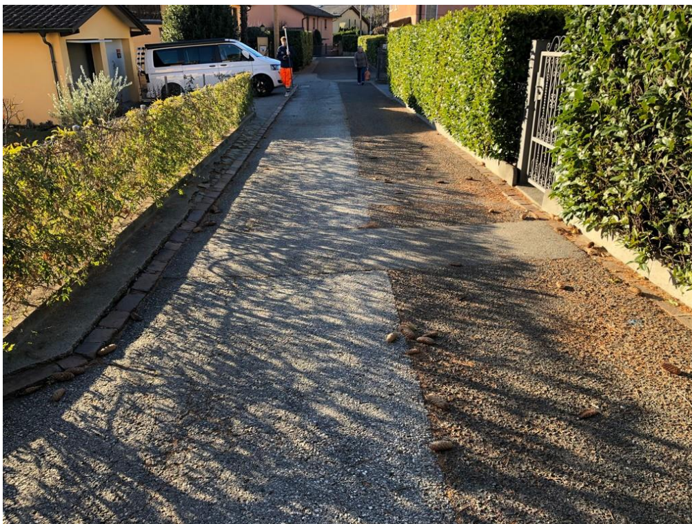
Foto no. 13 – Via Rovréd, stato della pavimentazione stradale
