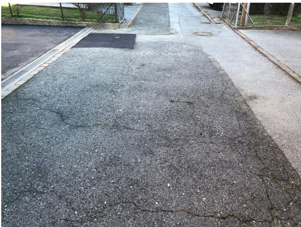
Foto no. 36 – Via Rovréd, stato della pavimentazione stradale
