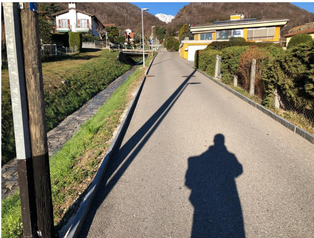
Foto no. 45 – Via Val Maggiore, stato della pavimentazione stradale verso monte
