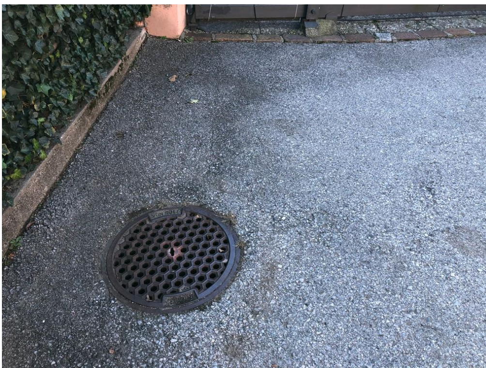
Foto no. 30 – Via Rovréd, stato della pavimentazione stradale con caditoia stradale
