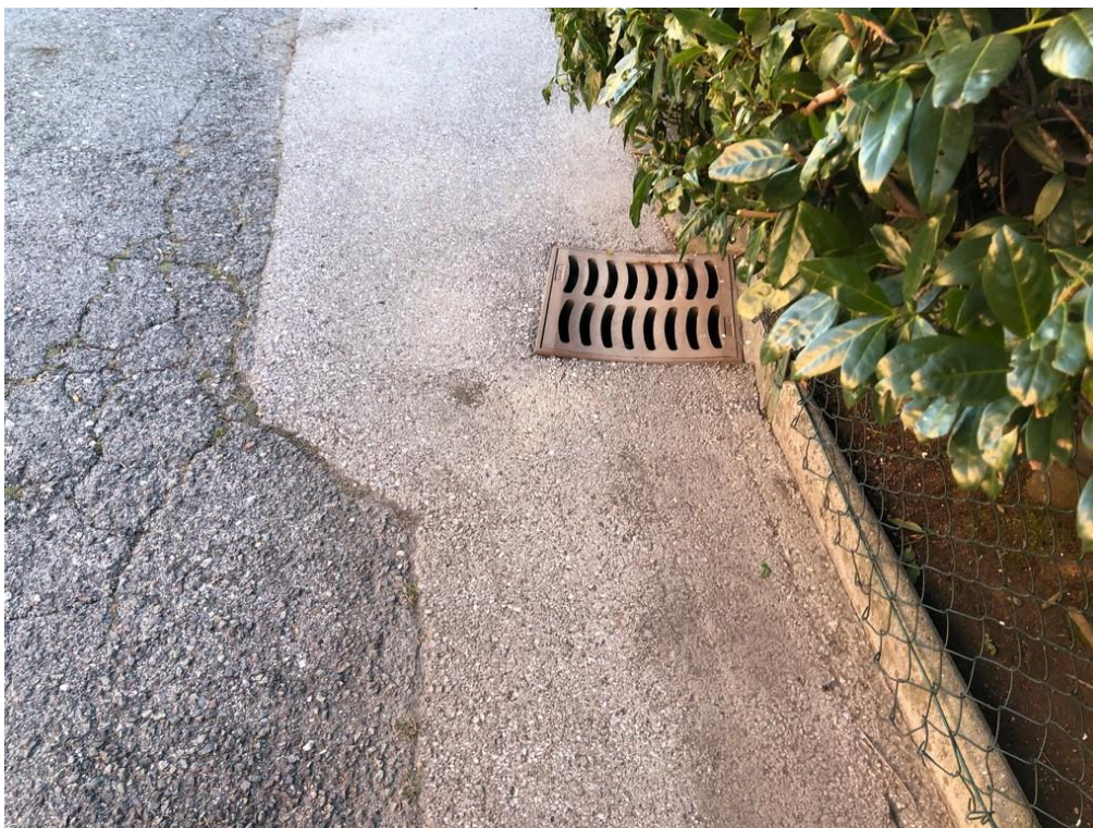
Foto no. 35 – Via Rovréd, stato della pavimentazione stradale con caditoia stradale
