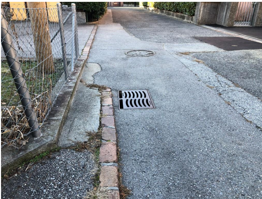
Foto no. 17 – Via Rovréd, stato della pavimentazione stradale a confine con il mappale 718
