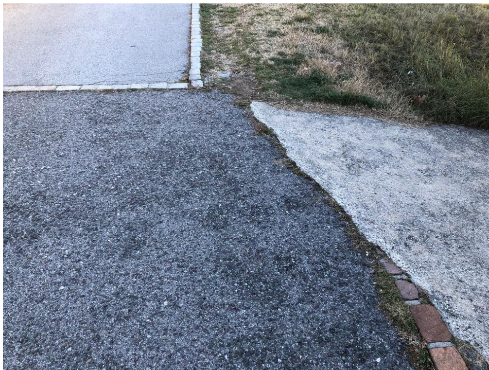
Foto no. 41 – Via Rovréd, stato della pavimentazione stradale a confine con il mappale 717
