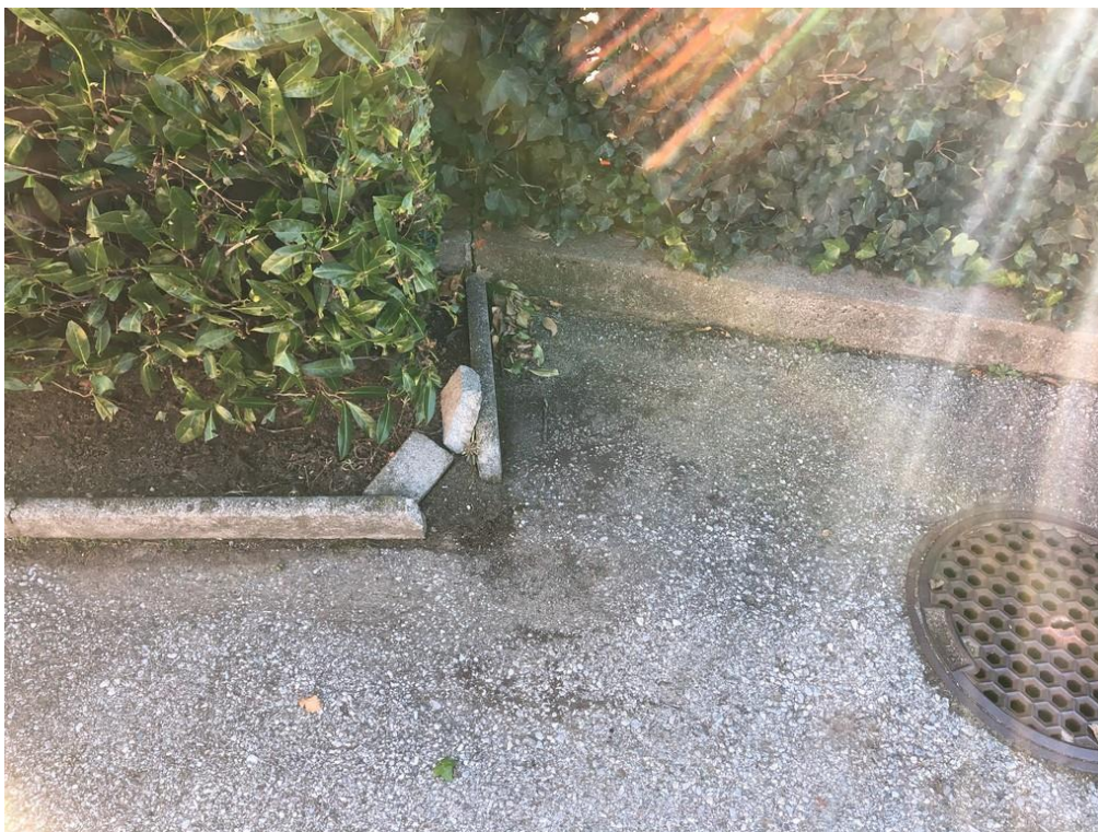
Foto no. 29 – Via Rovréd, stato della pavimentazione stradale a confine con il mappale 1208
