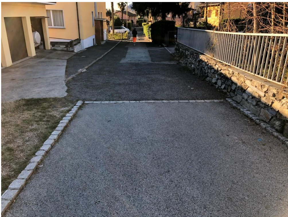
Foto no. 04 – Via Rovréd, stato della pavimentazione stradale
