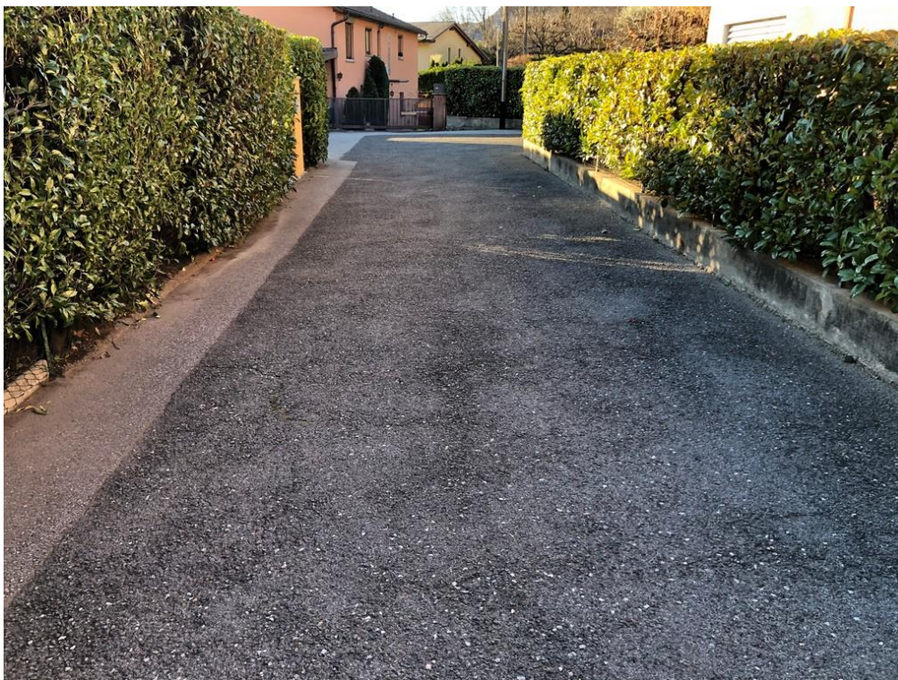
Foto no. 21 – Via Rovréd, stato della pavimentazione stradale
