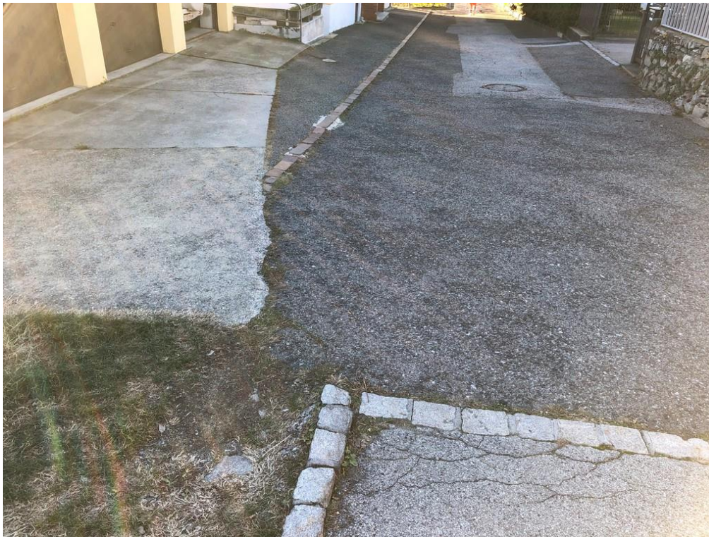
Foto no. 05 – Via Rovréd, stato della pavimentazione stradale a confine con il mappale 718
