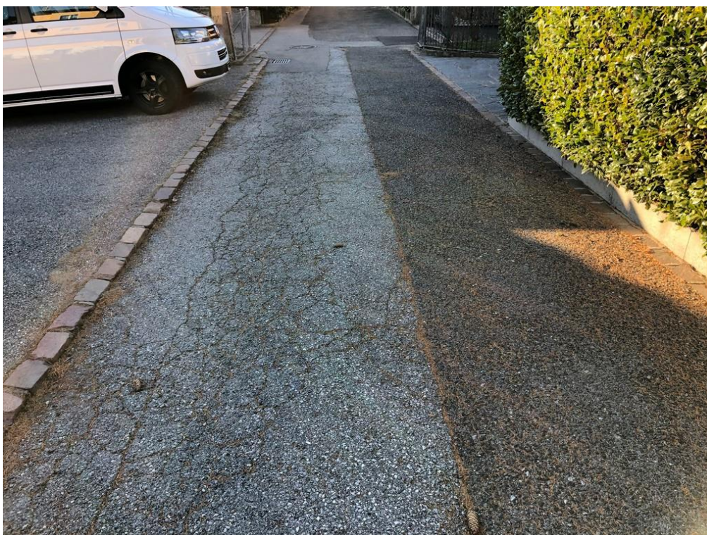
Foto no. 16 – Via Rovréd, stato della pavimentazione stradale
