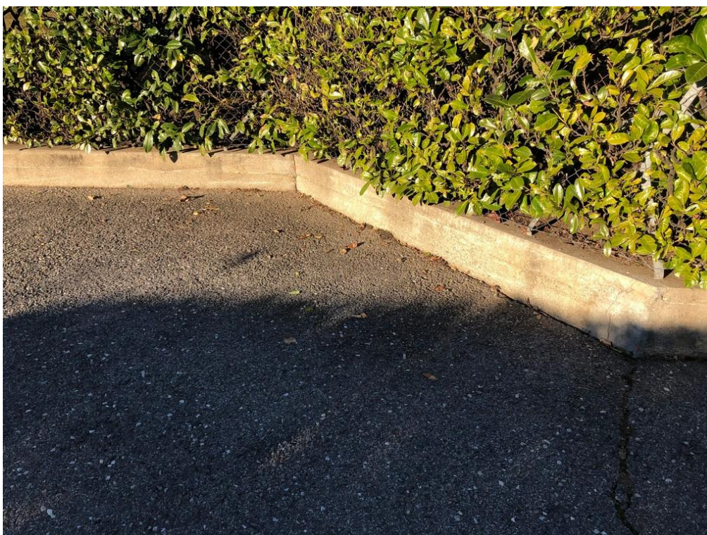
Foto no. 24 – Via Rovréd, stato della pavimentazione stradale a confine con il mappale 715
