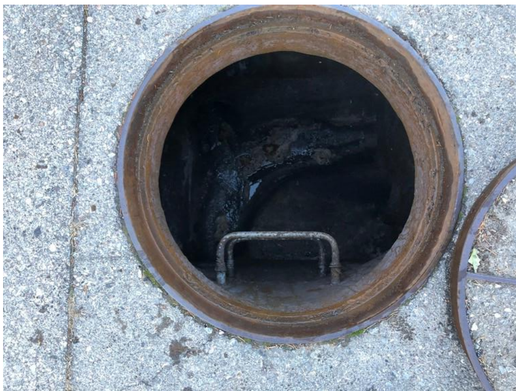
Foto no. 49 – Pozzetto n. 121600
