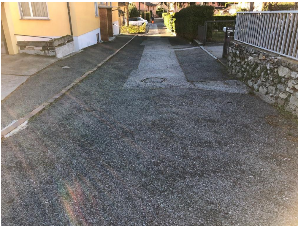
Foto no. 07 – Via Rovréd, stato della pavimentazione stradale
