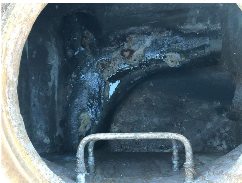
Foto no. 50 – Pozzetto n. 121600
