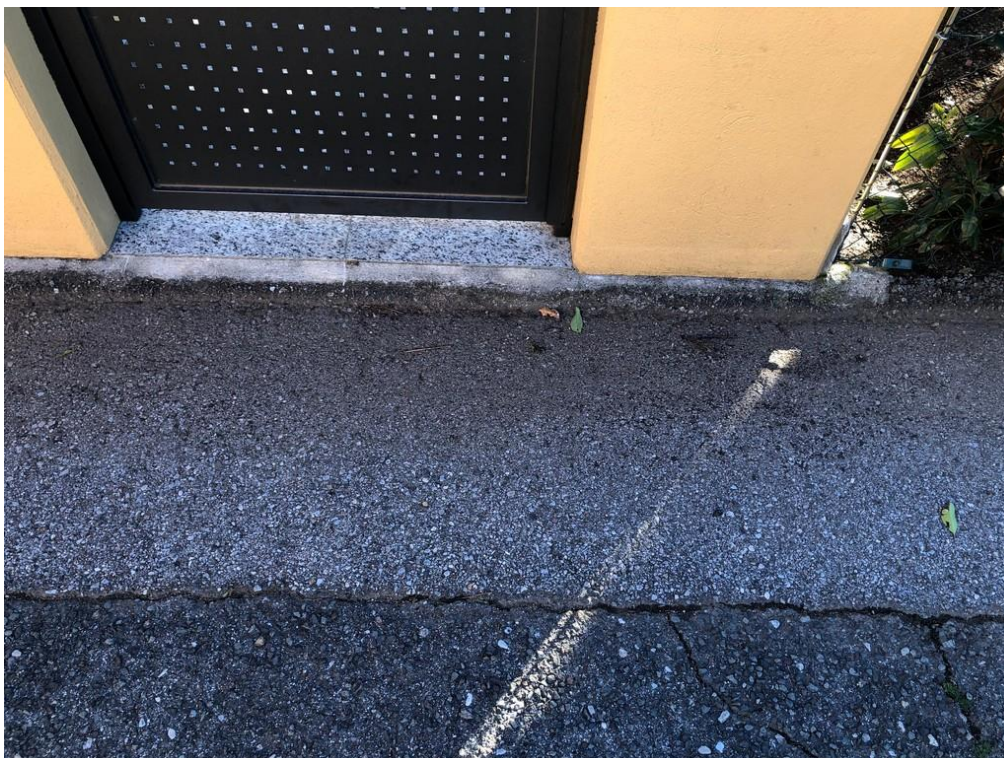
Foto no. 34 – Via Rovréd, stato della pavimentazione stradale a confine con il mappale 1208
