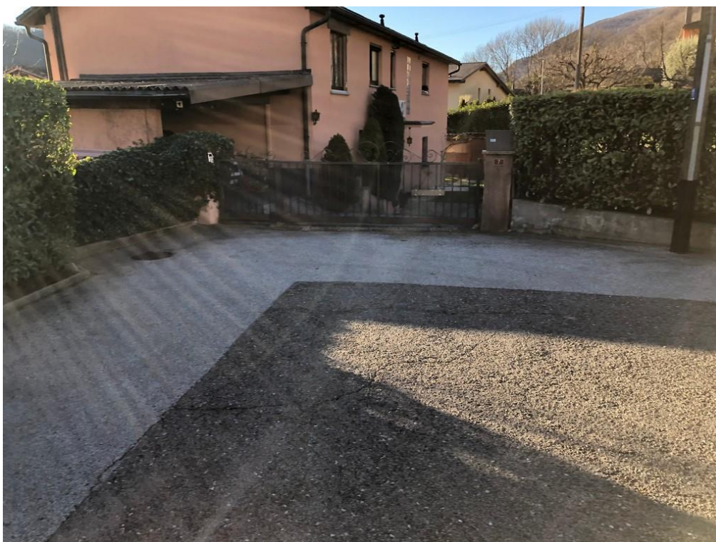
Foto no. 26 – Via Rovréd, stato della pavimentazione stradale
