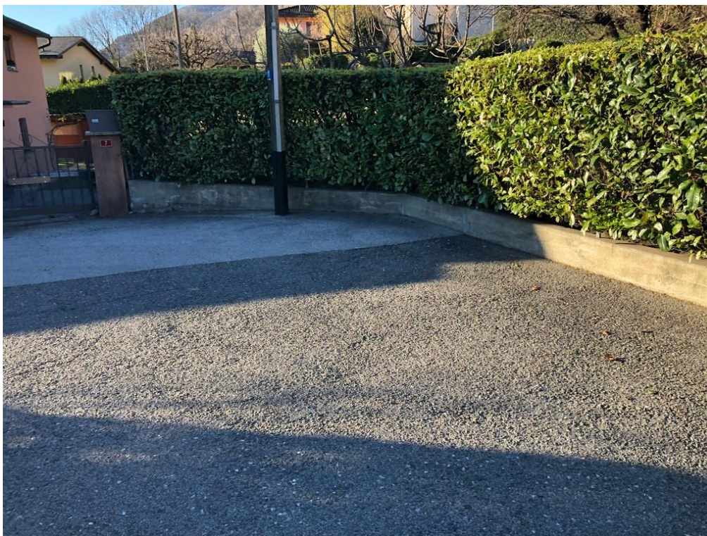
Foto no. 25 – Via Rovréd, stato della pavimentazione stradale
