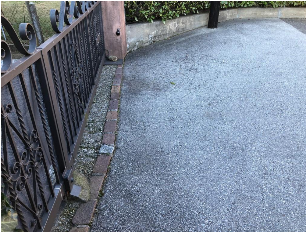
Foto no. 31 – Via Rovréd, stato della pavimentazione stradale a confine con il mappale 719
