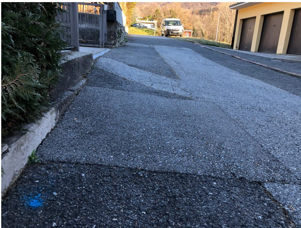
Foto no. 39 – Via Rovréd, stato della pavimentazione stradale a confine con il mappale 713
