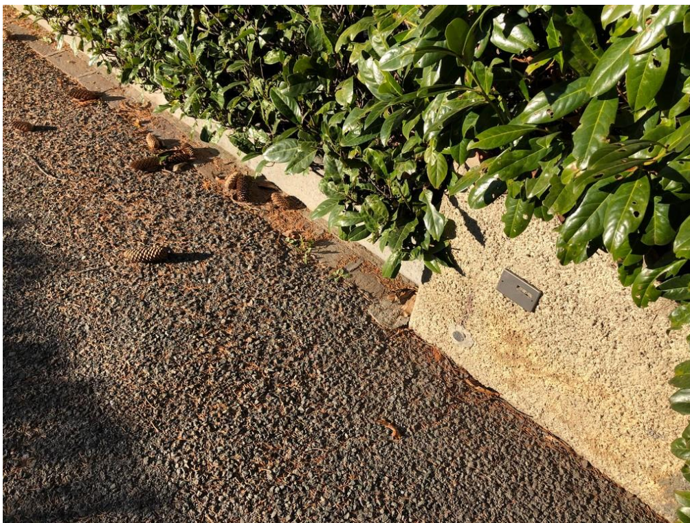
Foto no. 15 – Via Rovréd, stato della pavimentazione stradale a confine con i mappali 713 / 714
