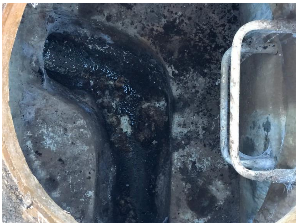
Foto no. 48 – Pozzetto n. 121590
