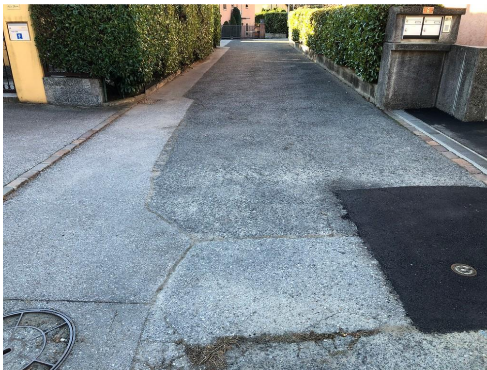
Foto no. 19 – Via Rovréd, stato della pavimentazione stradale
