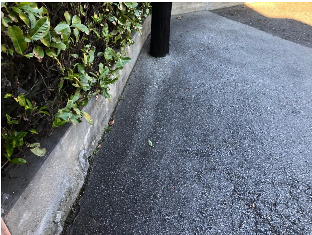
Foto no. 32 – Via Rovréd, stato della pavimentazione stradale
