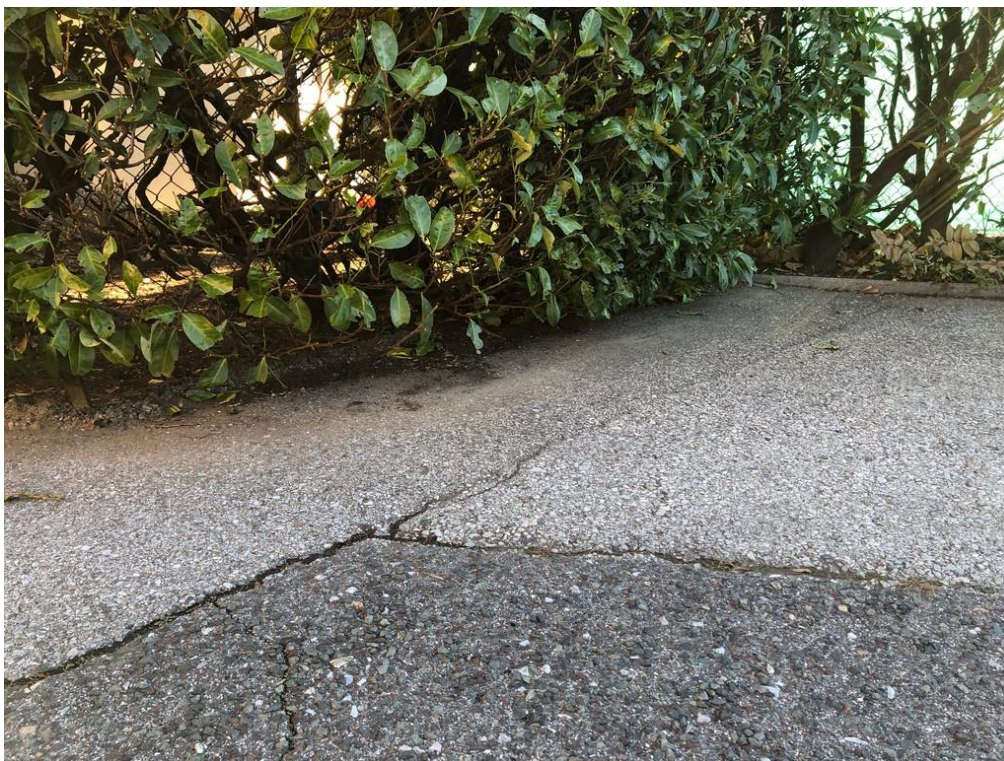
Foto no. 23 – Via Rovréd, stato della pavimentazione stradale a confine con i privati
