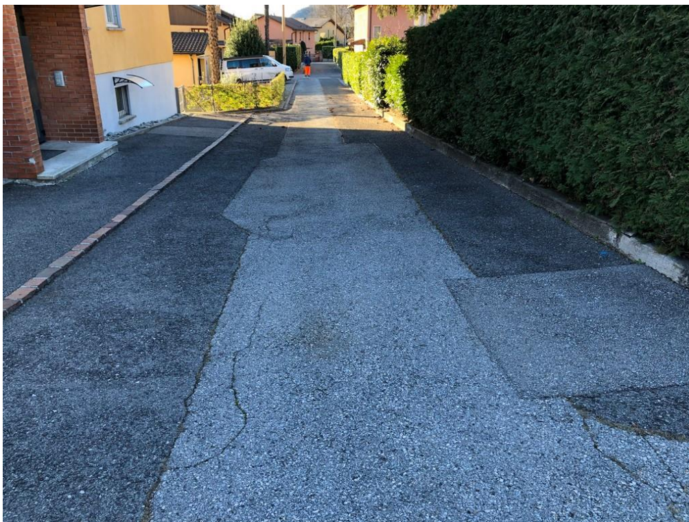
Foto no. 09 – Via Rovréd, stato della pavimentazione stradale
