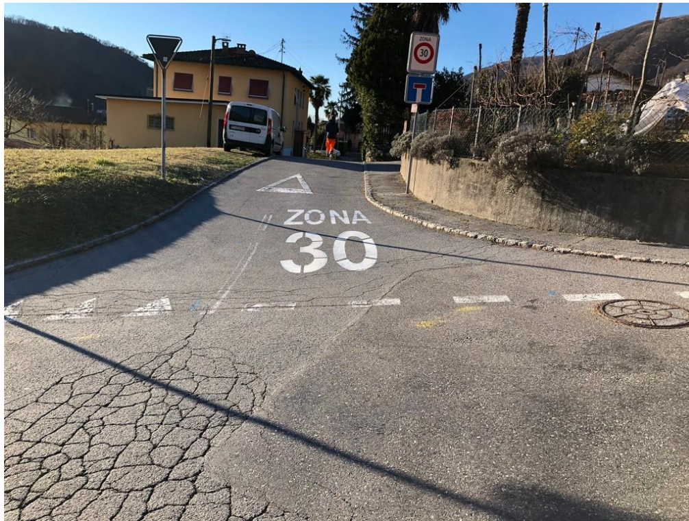
Foto no. 01 – Via Rovréd, incrocio con Via Comunale, stato della pavimentazione stradale
