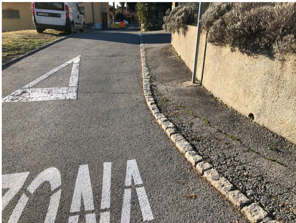
Foto no. 02 – Via Rovréd, stato della pavimentazione stradale a confine con il mappale 712
