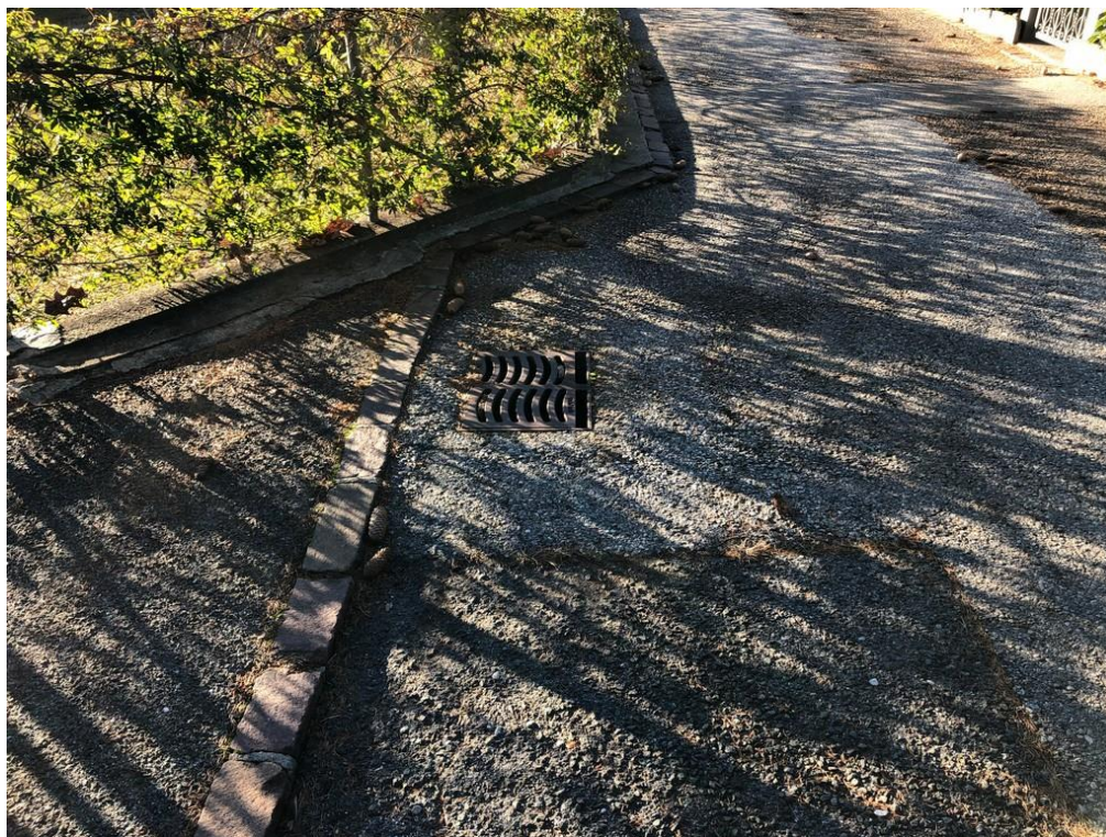
Foto no. 11 – Via Rovréd, stato della pavimentazione stradale a confine con il mappale 718
