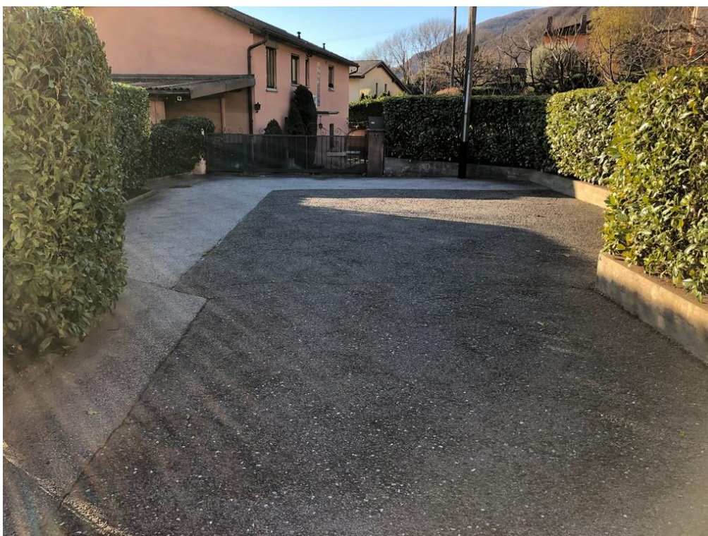
Foto no. 22 – Via Rovréd, stato della pavimentazione stradale
