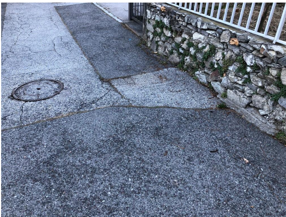
Foto no. 08 – Via Rovréd, stato della pavimentazione stradale e pozzetto n.121590
