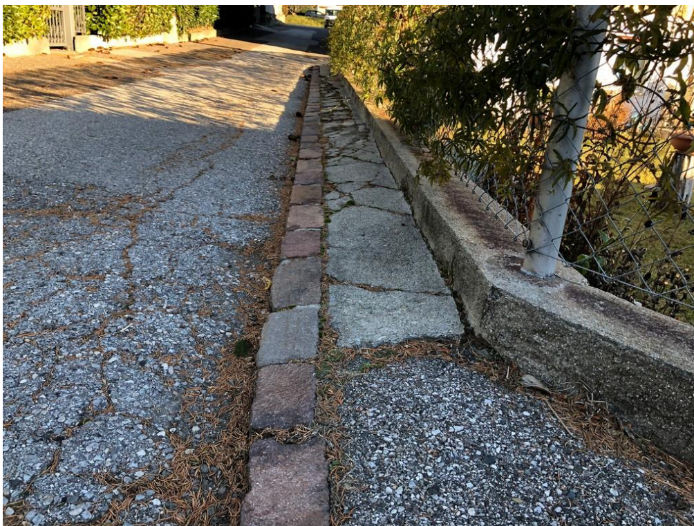
Foto no. 37 – Via Rovréd, stato della pavimentazione stradale a confine con il mappale 718
