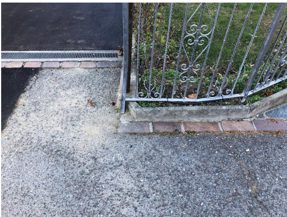
Foto no. 18 – Via Rovréd, stato della pavimentazione stradale a confine con i mappali 714 / 715
