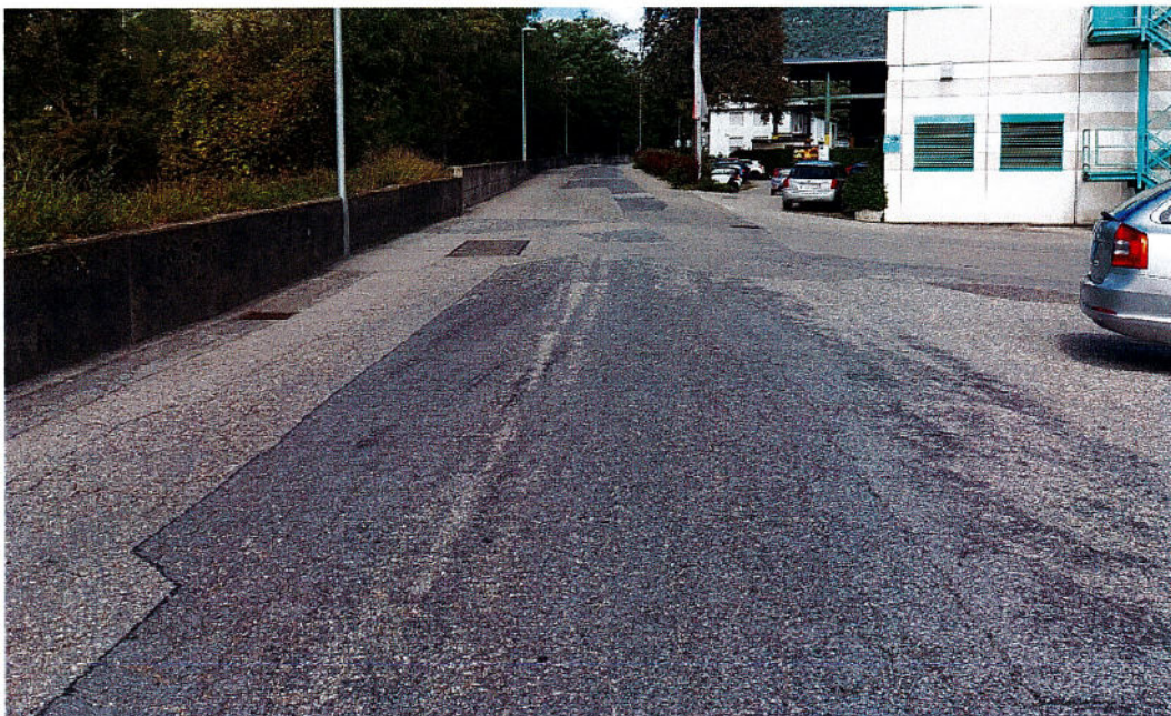
Figura 1: situazione pavimentazione Sud
